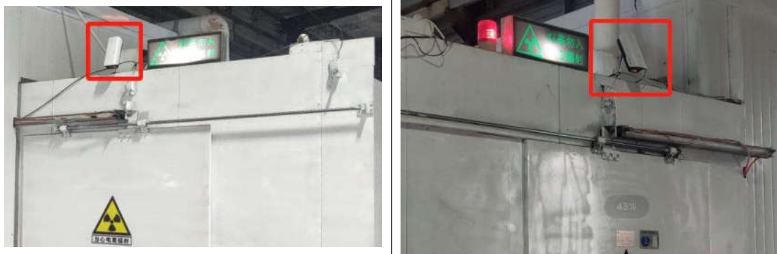
工件进出门外摄像头
