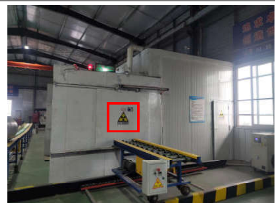
操作室门口及工件门警示标识
